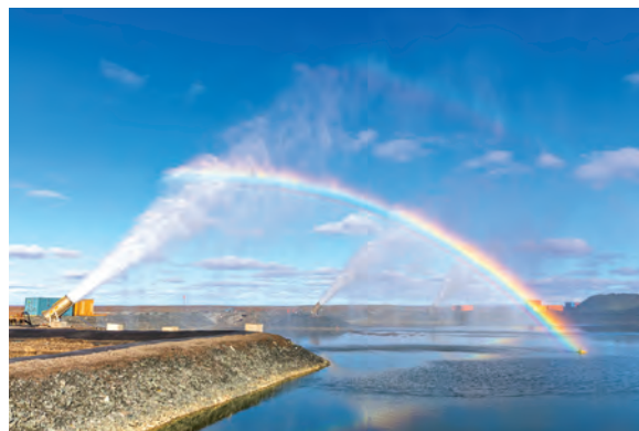
Les évaporateurs d'eau au projet Meliadine au Nunavut sont utilisés pour réduire le volume d'eau saline stockée à la surface, réduisant ainsi le potentiel de migration d'eau salée dans notre empreinte.
