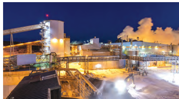
Les échangeurs thermiques de la mine Kittila contribuent à réduire les besoins et les coûts en énergie.
